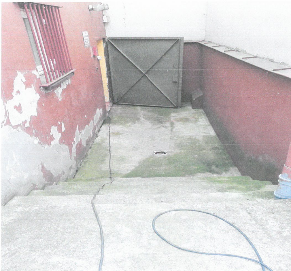
Fot. 14. Zewnętrzne zejście do piwnicznego węzła cieplnego. Zielone naloty glonów na schodach, posadzce i i przyposadzkowych strefach ścian – skutek rozbryzgiwania i zalegania wody opadowej.
