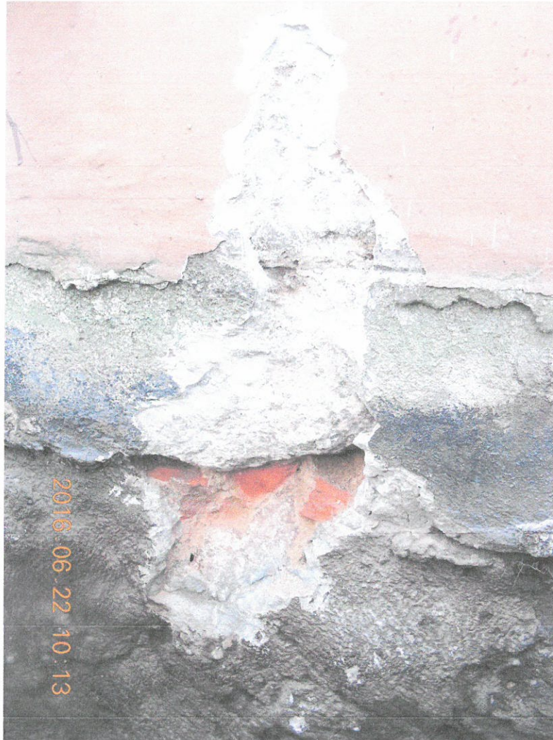
Fot. 2. Szczegół z fot. 1 – odkuwka tynków w poziomie terenu. Ściana piwnicy z kamienia na zaprawie wapienno-glinianej. Szeroka spoina między kamieniami wyszpałdowana odłamkami cegły ceramicznej. Próbka nr 1 cegły o wilgotności masowej 8% (średnio zawilgocona). Próbka nr 1' tynku (rapówki) o wilgotności masowej 11% (mocno zawilgocona). Próbka nr 1" zaprawy wapienno-glinianej o wilgotności masowej 5% (podwyższona wilgotność).
