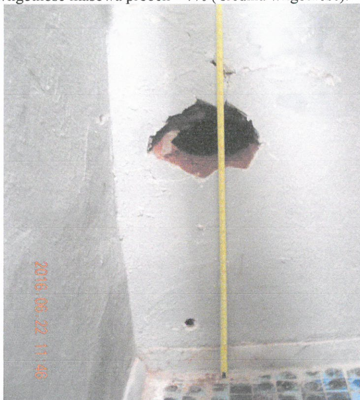
Fot. 9. Ściana wewnętrzna gr. 80 cm. Dwa nawierty kontrolne wykazały mur z cegły ceramicznej pełnej. Z odkucia nawiertu na wys. 63 cm licząc od posadzki wzwyż pobrano próbki cegły nr 8÷11. Wilgotność masowa próbek 7÷8% (średnia wilgotność). Próbki cegły skruszały. Tynk cementowy pomalowany farbą olejną – powłoki niedyfuzyjne.
