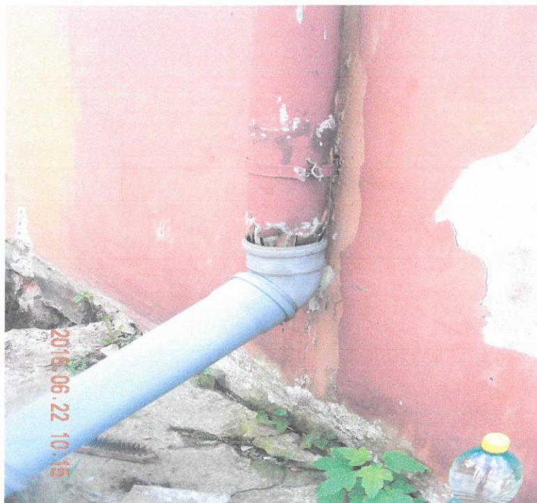
Fot. 6. Rura spustowa interwencyjnie uzupełniona – brak szczelności połączenia rury z kolanem. Przykład lichego (ogólnie) stanu technicznego rynien i rur spustowych.
