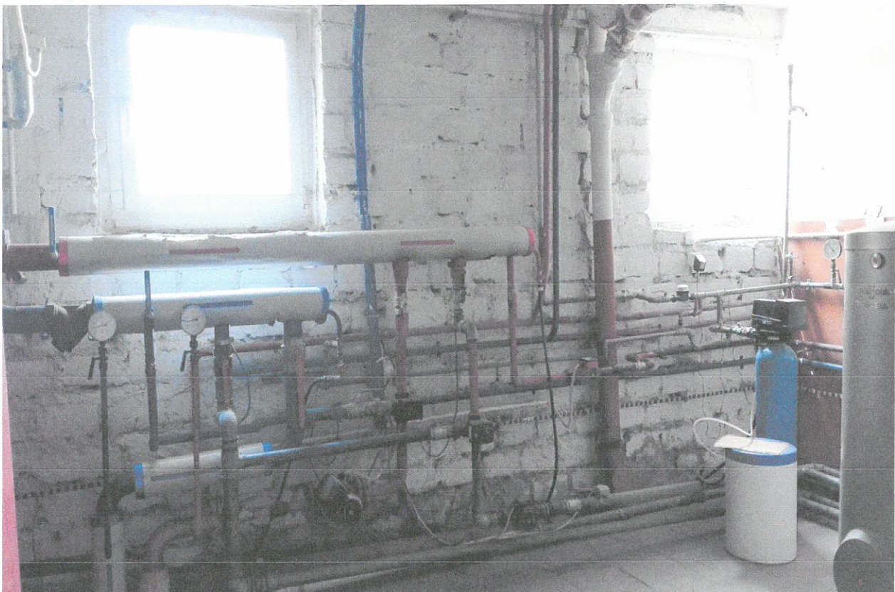
Fot. 13. Ściana zewnętrzna z fot. 11 i 12 od strony pomieszczenia węzła cieplnego. Mur z bloczków betonowych na mocnej zaprawie cem-wap., nieotynkowany, pomalowany farbą emulsyjną. Spoiny niepełne, z licznymi ubytkami. Ślady po przeciekach wody z gruntu poprzez nieszczelności muru.
