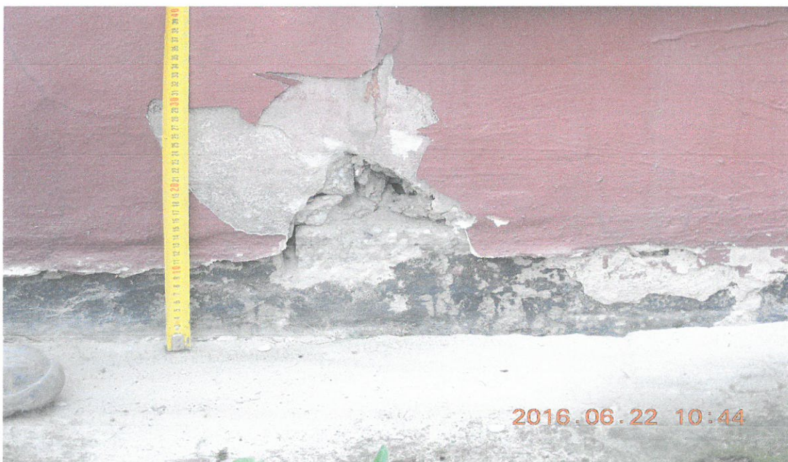
Fot. 11. Odkuwka zewnętrznej ściany piwnic nad opaską betonową. Mur z bloczków betonowych na mocnej zaprawie cem-wap. Spoina niepełna, z ubytkami. Tynk cokołowy cem-wap. Opaska betonowa zapadnięta. W strefie opaski i gruntu mocny tynk cem-wap. (rapówka) pokryty b. cienką hydroizolacją bitumiczną. Hydroizolacja nieciągła.
