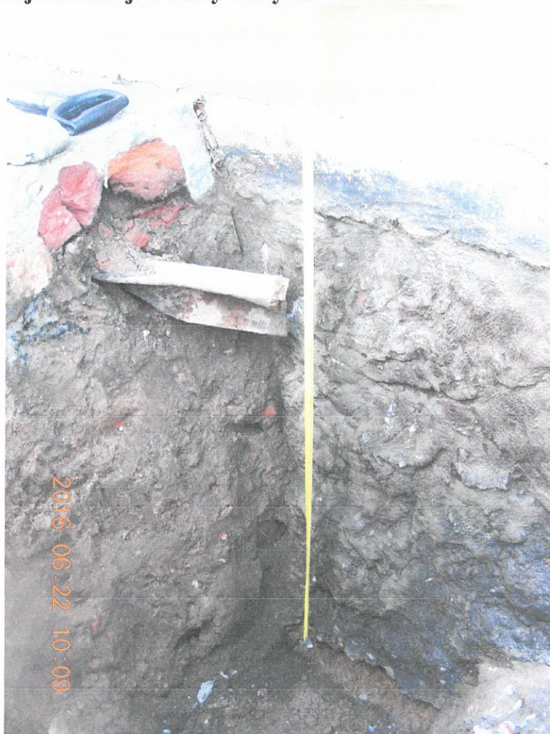
Fot. 1. Odkrywka nr 1 - do głębokości posadowienia 110 cm p.p.t. Brak wyodrębnionej ławy fundamentowej. Ściana piwnicy z kamienia, otynkowana cementowym tynkiem (rapówką). Tynk niezatarty, niewyrównany, nieodspojony od muru kamiennego. Hydroizolacja pionowa z roztworu asfaltowego, b. cienka, ciągła.
