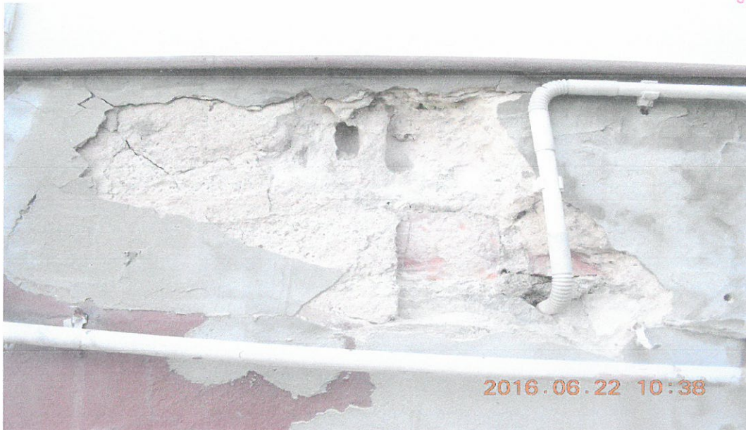
Fot. 12. Ściana z fot. 11 - odkuwka spękanego tynku pod gzymszem cokołowym. Mur zróżnicowany materiałowo (cegła ceramiczna, bloczek silikatowy drażony).
