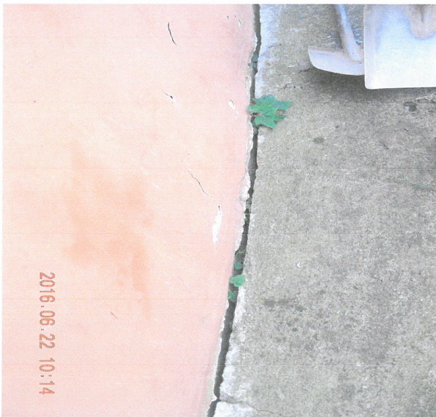
Fot. 4. Opaska betonowa odspojona od ściany, co umożliwia infiltrację wody pod opaskę. Stwierdzono, że grunt pod opaską jest bardziej zawilgocony niż poza opaską (w wykopie).
