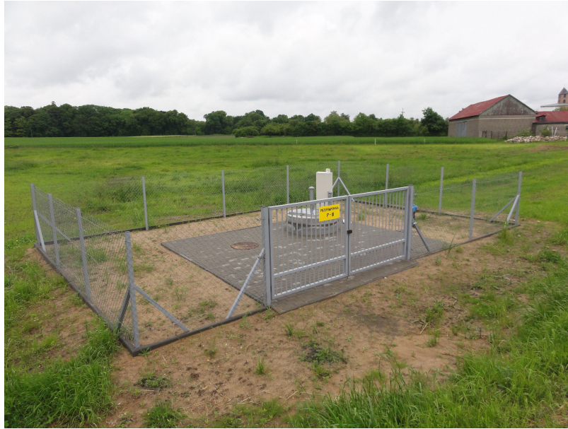
Fot. 14 Przepompownia ścieków we wsi Wielgie
